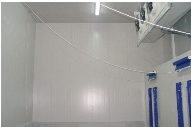
Cámara frigorífica realizada con paneles Isofrigo.
